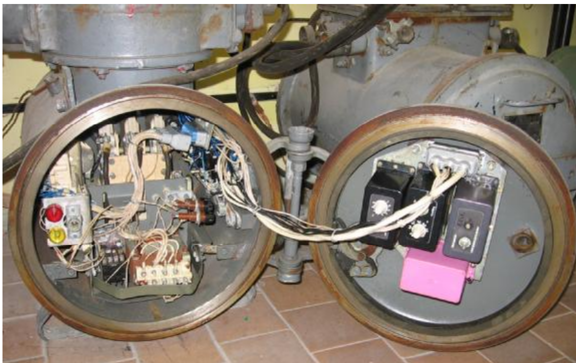
Рисунок 14 – Осмотр электрооборудования рудничного пускателя ПВИ-125 БТ.
